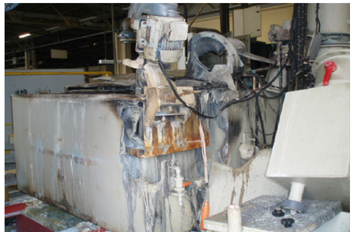
Domages incendie sur un réservoir en plastique
